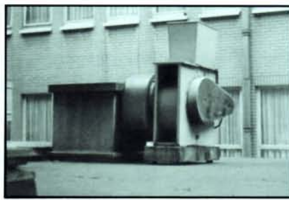
△ Isolierung einer Klimaanlage auf einem Betonsockel.
