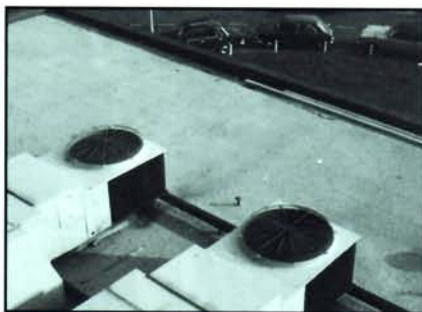
△ Isolierung von Klimaanlagen auf den Dächern von Gebäuden.
