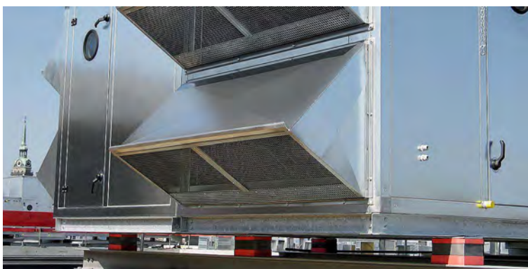
Lagerung eines Klimageräts auf dem Dach eines Gebäudes
