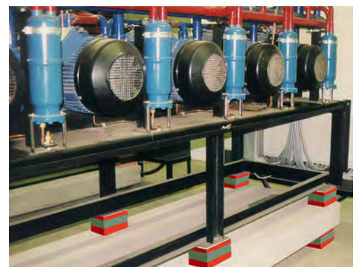
Lagerung eines Kältekompressors
