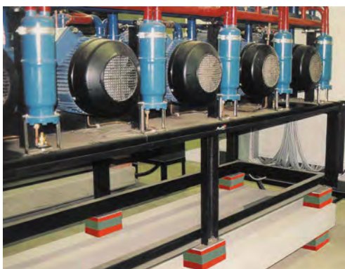
Lagerung eines Kältekompressors
