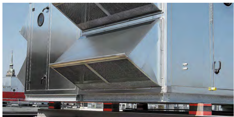
Lagerung eines Klimagerätes auf dem Dach eines Gebäudes
